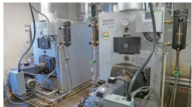
図22 蒸気ボイラー
